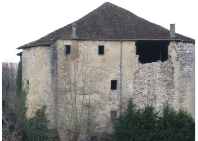
2011 – Côté Est. 2 ème effondrement : large trou béant
