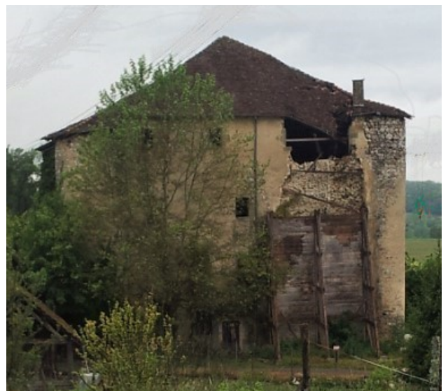
2014 – Le toit s'effondre... et les dégradations s'accroissent de jour en jour
