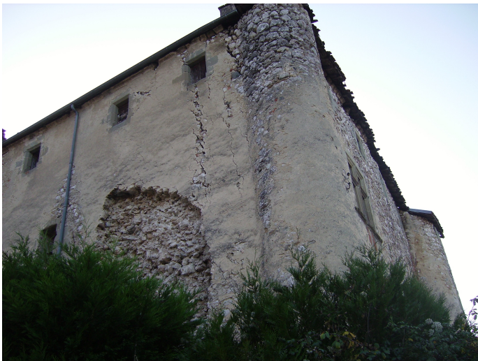
2007 – Côté Est : 1 er effondrement du parement
