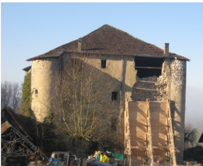
2011 – Sécurisation du site par simple étagage en bois Rien n'a été fait depuis cette date
